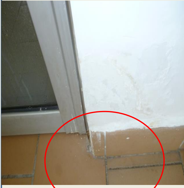
HUMEDADES GENERALES EN ÁREA DEL TURCO EN PATA DE LOS MUROS
