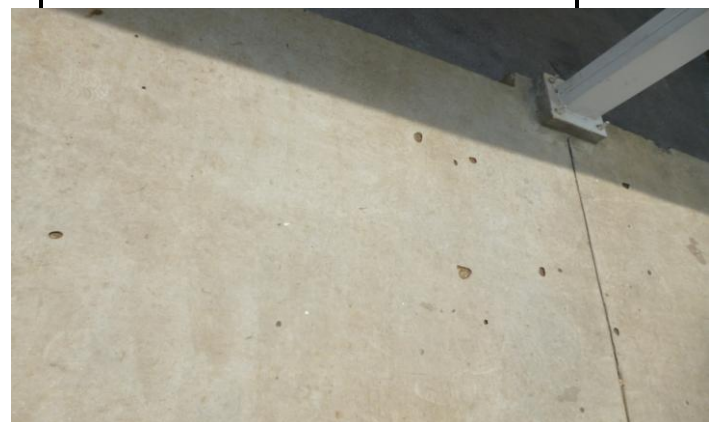
ANDENES CON HUECOS EN EL CONCRETO GENERALIZADO EN TODAS LAS CIRCULACIONES
