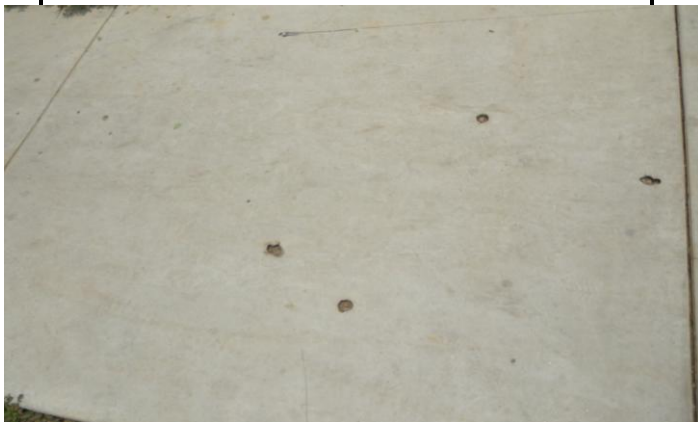
ANDENES CON HUECOS EN EL CONCRETO GENERALIZADO EN TODAS LAS CIRCULACIONES
